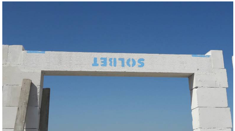
Rys. 18. Nieodpowiednio [odwrotnie] zabudowane nadproże na budowie
