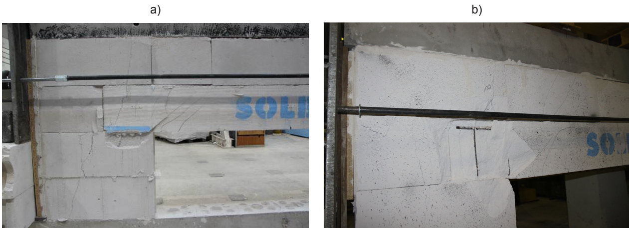
Rys. 14. Widok uszkodzeń modelu serii NIII: a) strefa podporowa, b) zmiżdżenie ABK nadproży w strefie przypodporowej
