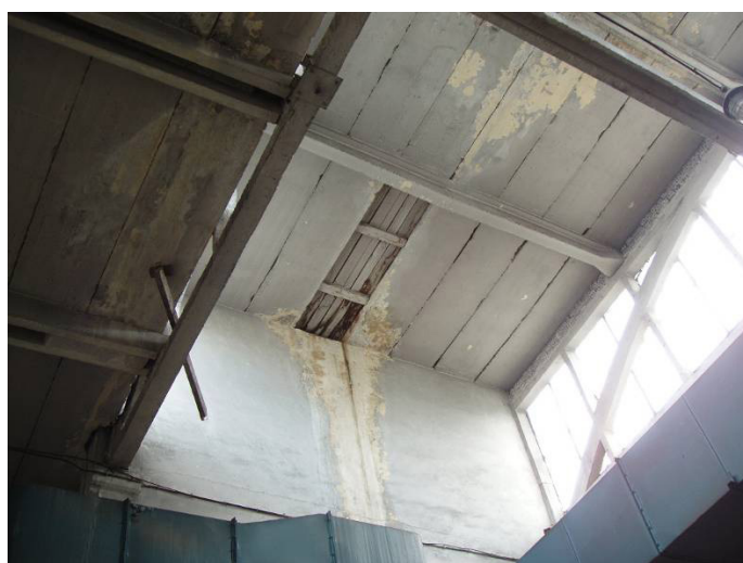
Rys. 6. Niefachowa naprawa załamanej pianobetonowej płyty dachowej. Uszkodzenie płyty wystąpiło na skutek przecieków i korozji zbrojenia
