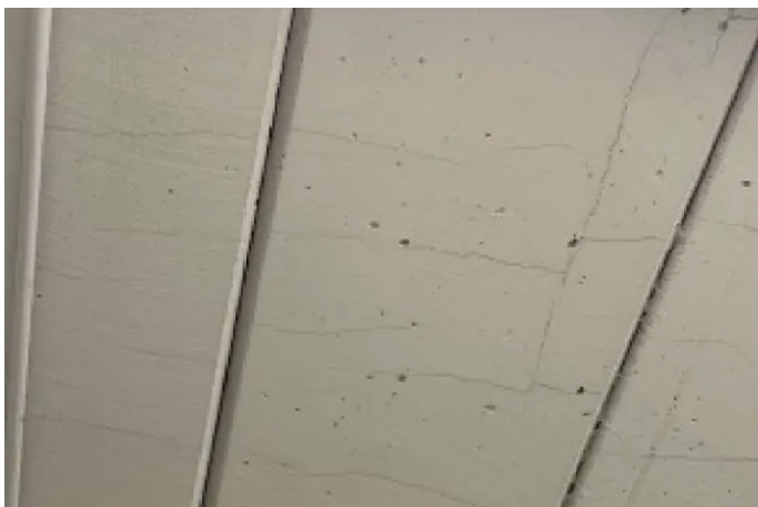
Rys. 1. Zarysowania płyt stropowych w Wielkiej Brytanii (2)
