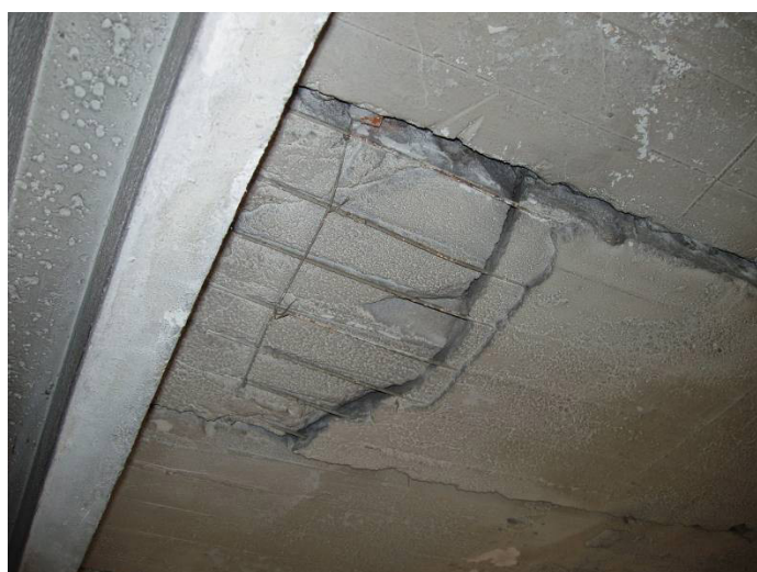
Rys. 5. Załamanie pianobetonowej płyty dachowej spowodowane przeciążeniem
