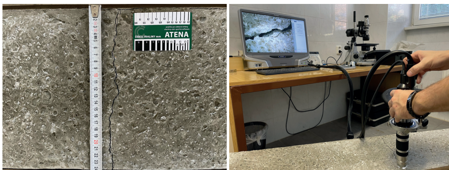
Rys. 2. Pęknięcia powstałe w wyniku skurczu plastycznego betonu
